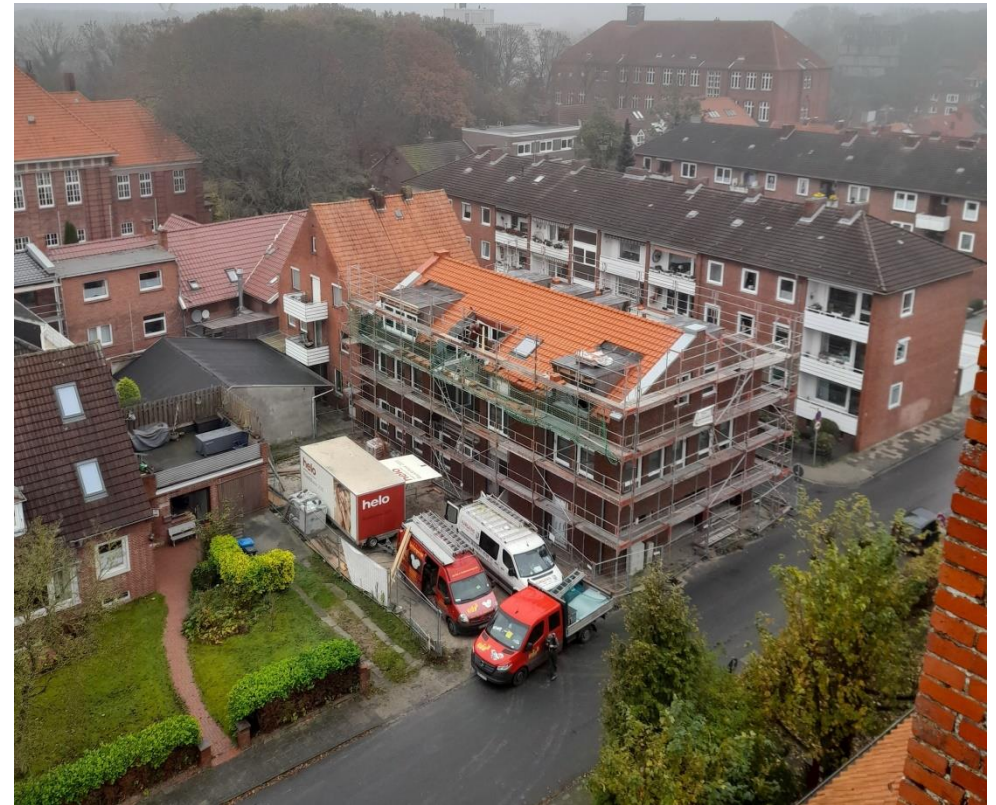
Aus der Höhe am Turm ergab sich ein besonderer Blick auf das neue Pfarrhaus, welches den Fortschritt der Arbeiten zeigt.
